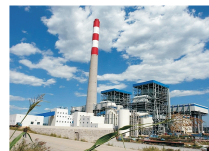
▲ 沙特拉比格项目 (双启动锅炉)
